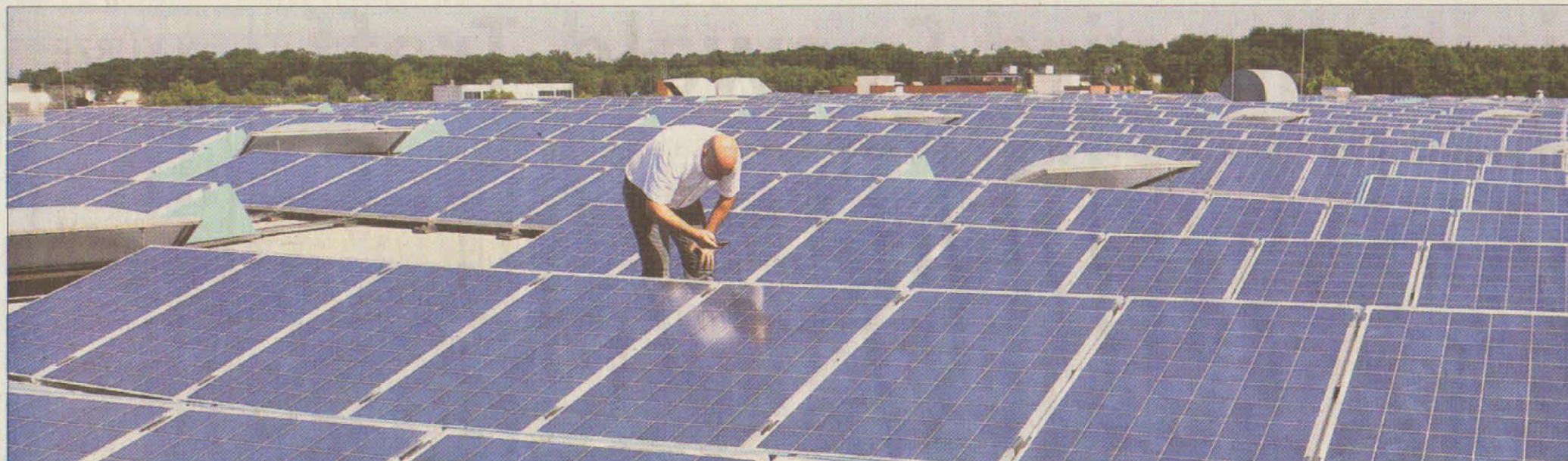
Blau sind die Photovoltaik-Module, die grünen Strom für rund 1400 Menschen erzeugen. Mehr als 4300 Stück befinden sich auf dem Dach des Kaufhof-Textillagers an der Waldstraße, weitere Einheiten wurden auf dem Dach eines anderen gewerblich genutzten Gebäudes, ebenfalls an der Waldstraße, montiert. Fotos (2): El Cheikh
